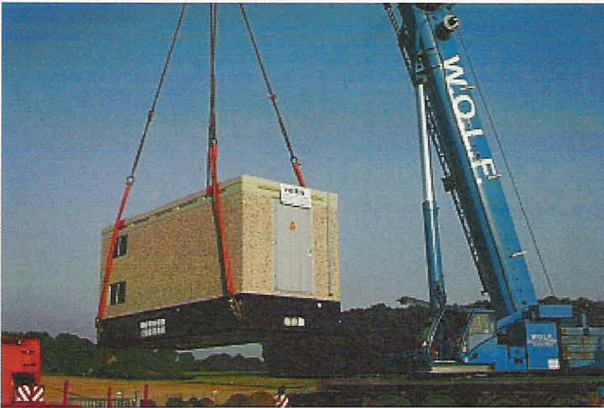
Per Kranwagen gelangte das 46 Tonnen schwere Trafohäuschen an seinen Platz. Foto: Stadt Dülmen/Peter Mering.
